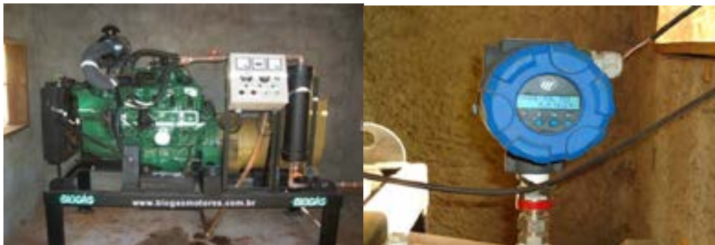
Figura 04: Conjunto Motor-Gerador e Medidor de Consumo de Biogás
